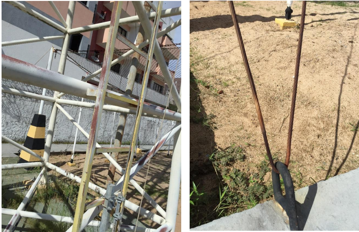
Figura 13a e 13b: Torre com ferros e cabos enferrujados.
