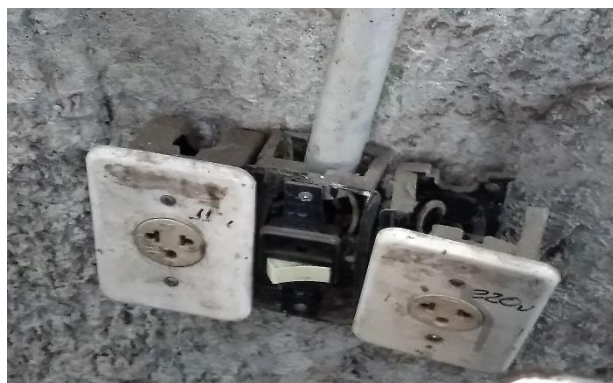
Foto das tomadas da empresa Toyotec
